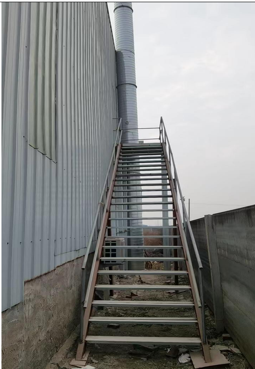
給料、破碎工序排气筒
