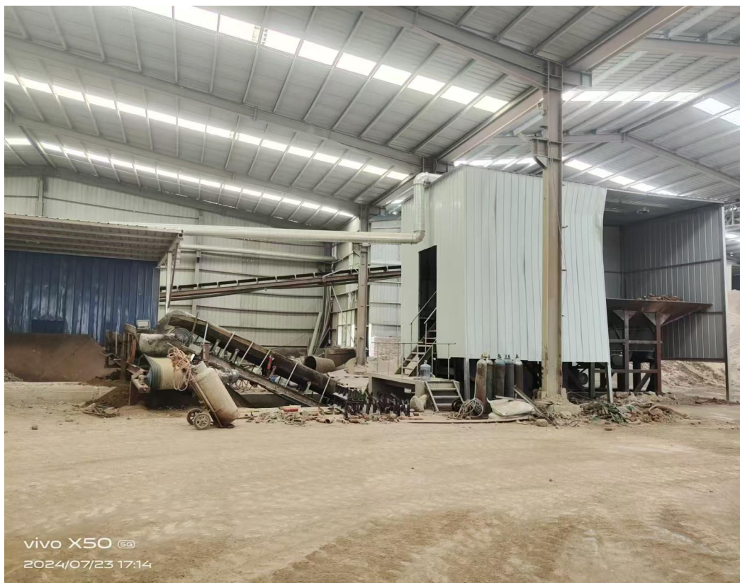
已验收部分新增颚式破碎机废气集气罩
